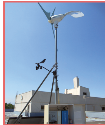
風力発電装置
